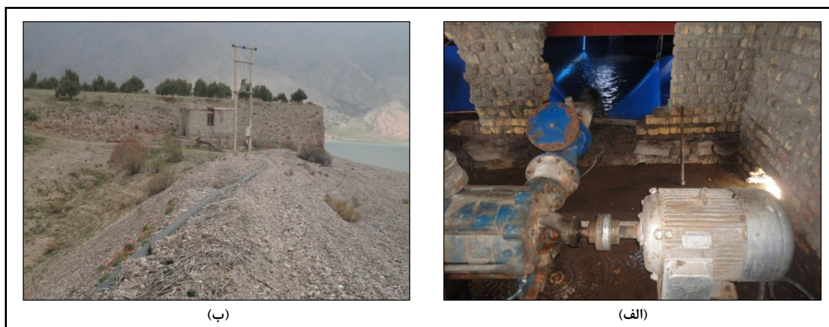
شکل ۱- ایستگاه پمپاژ ثانویه (الف) و ایستگاه پمپاژ اولیه (ب) در سامانه آبیاری مورد مطالعه
