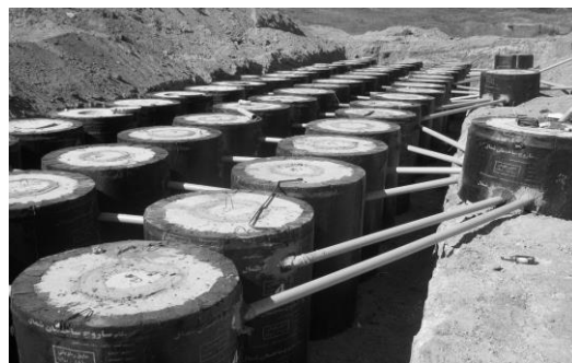
تصویر شماره ۱: نمایی از سیستم بی هوازی (سپتیک تانک)
