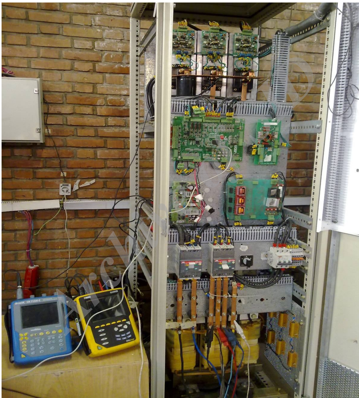
شکل (۳۲) نمای تابلوی اینورتر.
