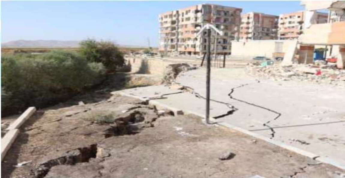
شکل ۱. نمونه‌ای از ترک‌های ناشی از استرس جانبی در مجتمع مسکونی شهید شیرودی. ترک‌های متعدد دیگری در زیر بستر مجتمع و دورتر از لبه ترانشه دیده می‌شود
