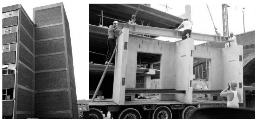
شکل شماره (۳) : دیوار برشی پرکننده آجری (سمت چپ)، قطعه پیش ساخته مربوط به آسانسور (سمت راست)
