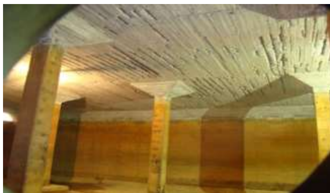
شکل شماره (۱۷) زخمی کردن نقاط معیوب طبله شده، رسوب زده، حفره ها، خلل و فرج ها و ... در سقف
