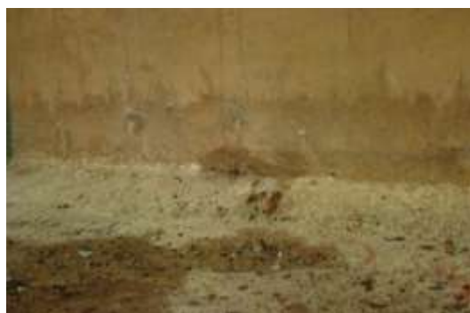
شکل شماره (۱۰) وجود نشستی در دیواره میانی مخزن
