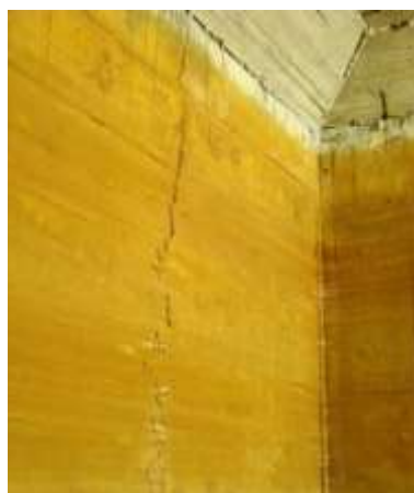
شکل شماره (۸) رسوب گذاری در بدنه و مشکل در محل درز اجرایی
