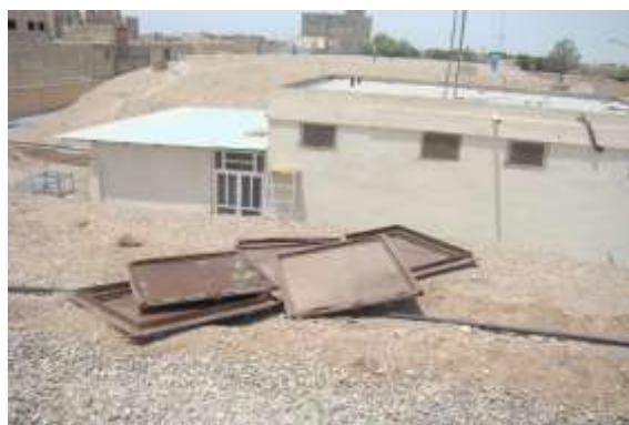
شکل شماره (۱۶) خوردگی دریچه های فولادی مخزن
