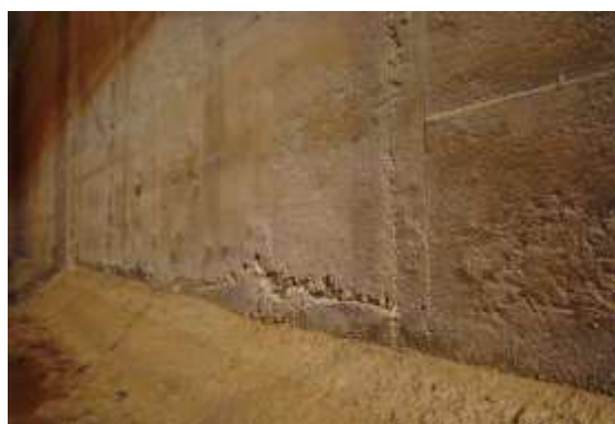
شکل شماره (۷) وجود خلل و فرج در بدنه به دلیل مشکلات اجرایی
