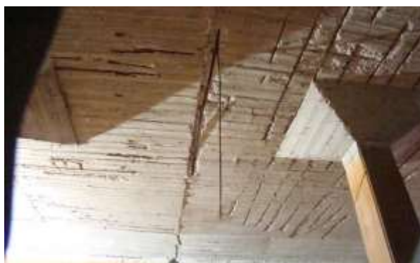
شکل شماره (۱): بیرون زدگی میلگردها از زیر سقف
