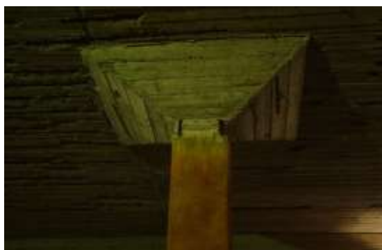
شکل شماره (۹) تخریب سرستون به دلیل خوردگی شدید میلگردها
