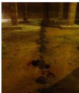
شکل شماره (۱۲) بیرون زدگی ماستیک درز انبساط
