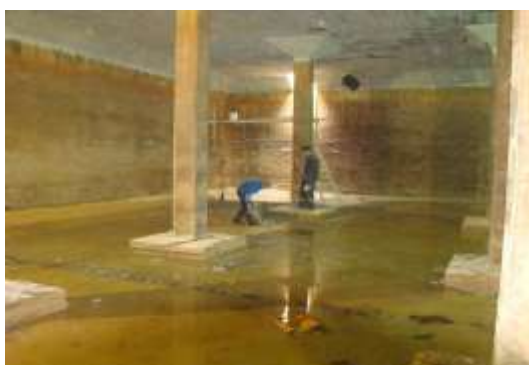
شکل شماره (۱۱) شیب بندی نامناسب کف
