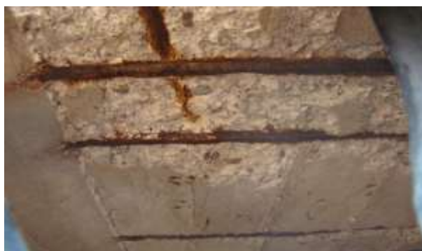
شکل شماره (۲) خوردگی شدید بتن و میلگرد بواسطه ضخامت نامناسب پوشش بتن
