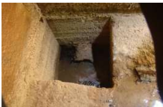
شکل شماره (۱۳) خوردگی شدید لوله شستشوی مخزن
