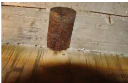
شکل شماره (۱۴) خوردگی لوله ورودی مخزن
