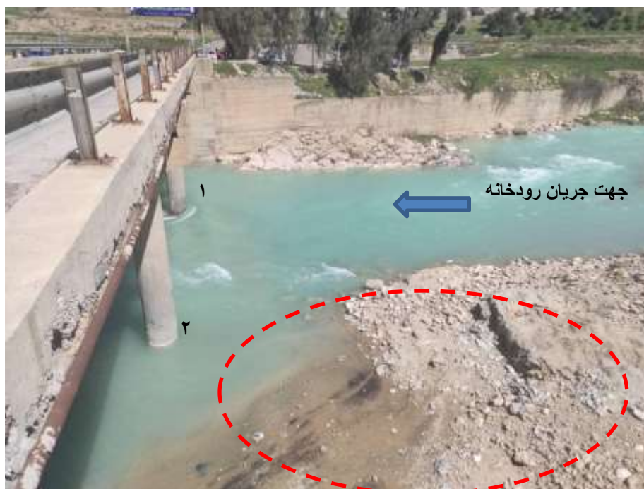
شکل ۲ نمونه ای از اثر جریان و وقوع آبشستگی در اطراف پایه پل
