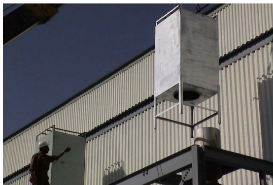
شکل ۳: نصب سایلنسر بر روی blow-off شماره ۱
