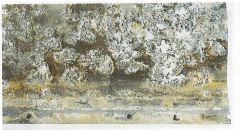
شکل ۳- صفحه مبدل در آب چاه برج خنک کننده باز در نیروگاه H
