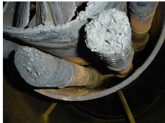
شکل (5-الف): سوختگی نازل‌های گاز و استابلایزرها
