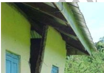
شکل 4 شکست خارج از صفحه‌ی دیوار باربر و اتصال نامناسب آن به سقف خرابی
