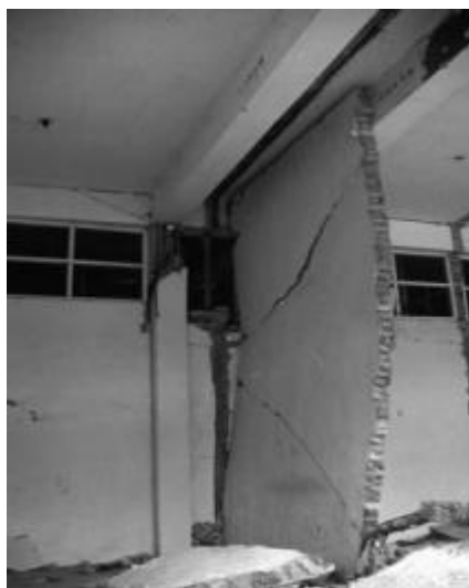
شکل 1 فروریزش جزئی دیوار پرکننده آجری غیر مسلح در خمش خارج از صفحه
