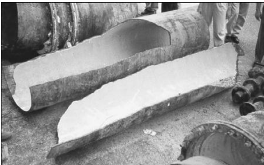
شکل(1): شکست لوله 800 میلیمتری در سیستم انتقال آب، زلزله کوبه. [2]
