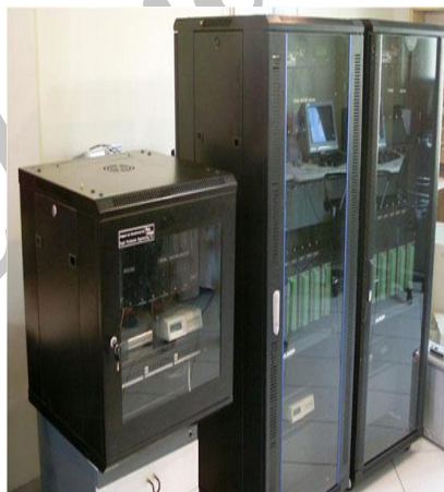
شکل (1): نمونه ای از تجهیزات منصوبه در پایانه های راه دور مخابراتی (RTU) بعنوان اجزای غیر سازه ای
