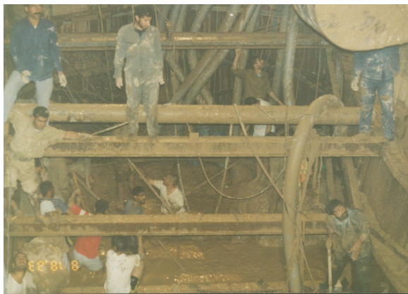
شکل ۱۵- پمپاژ آب و لایروبی درون قالب و انجام عملیات فلزی و بتنی
