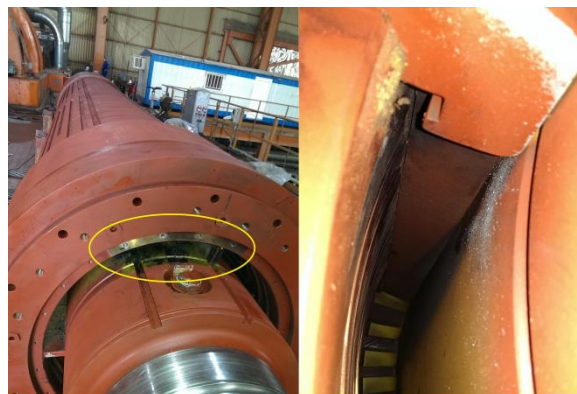
شکل ۵: سوختگی ناشی از جرقه در یک منطقه از روتور.
