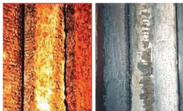
شکل ۶-الف: لوله کثیف و رسوب گرفته شده (قبل از شست‌وشوی)
