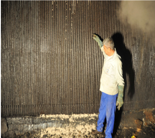
شکل (۶): دیواره بویلر واحد ۳ بعد از عملیات قلیا شویی
