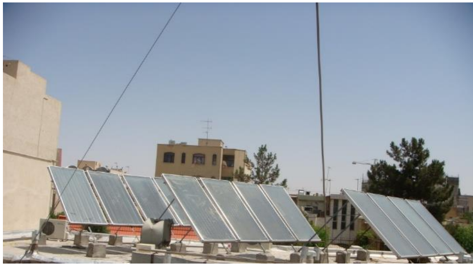
شکل 2- نمایی از آب گرمکن‌های خورشیدی نصب شده در بام ساختمان
