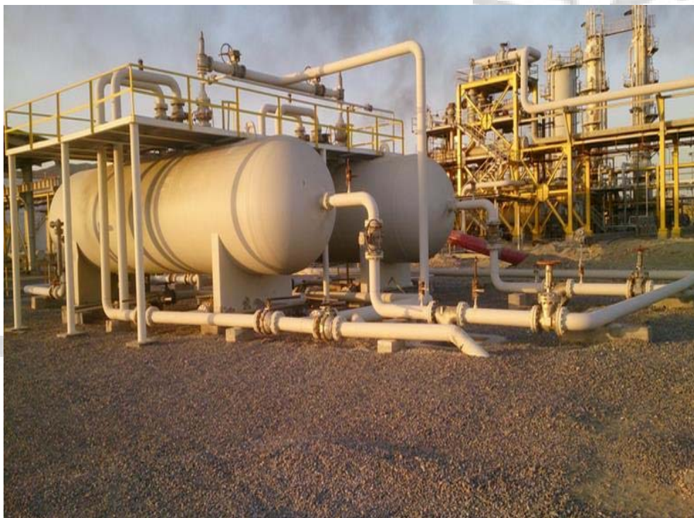
شکل ۳. نمای کلی از ظروف لجن گیر
