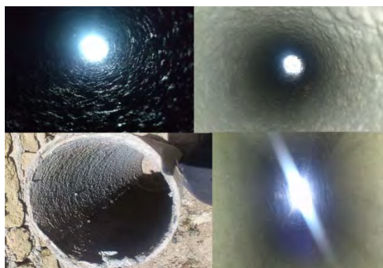
شکل ۱۱: زبریه‌های مختلف سطح داخلی دودکش بتنی
