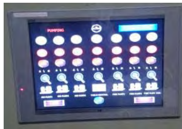
شکل ۶: تابلو کنترل مربوط به مانیتورینگ تجهیزات تاسیسات مکانیکال
