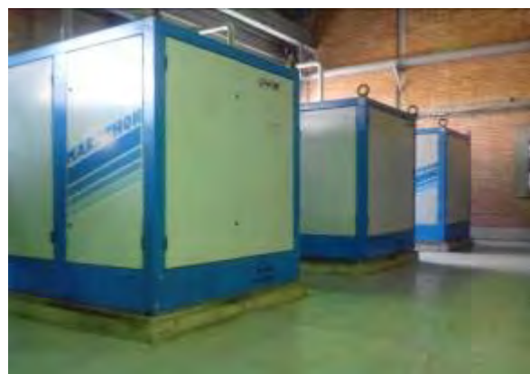
شکل ۱۰: کمپرسورخانه ( کمپرسورهای هوای فشرده ۱۳ بار)
