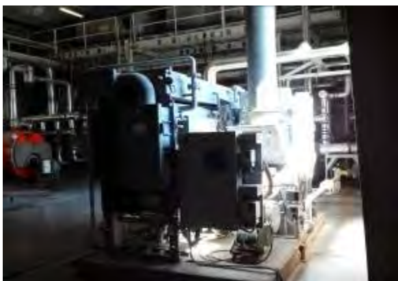
شکل ۸: تجهیزات مربوط به سیستم سرمایش موتورخانه مرکزی
