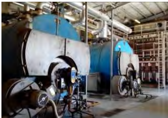
شکل ۷: تجهیزات مربوط به سیستم گرمایش موتورخانه مرکزی
