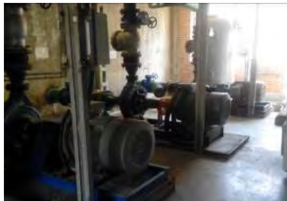
شکل ۹: سیستم خنک کننده آب صنعتی (الکتروپمپ های سیرکوله آب)
