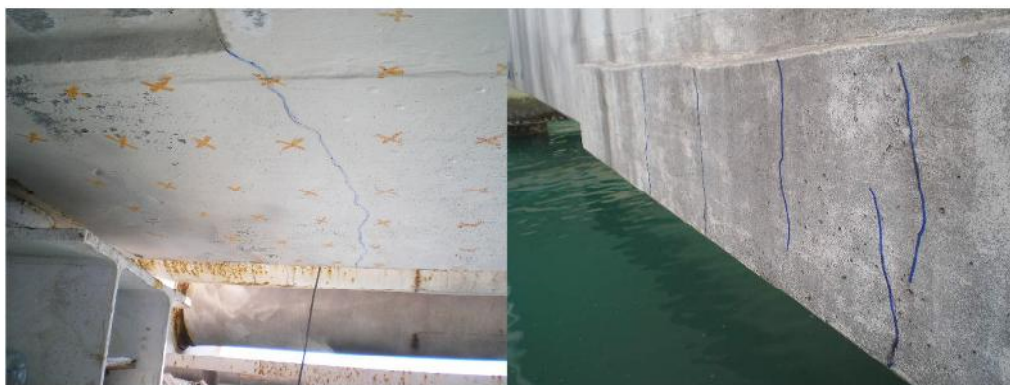
شکل ۱۵- آسیب دیدگی بتن ترمیمی
