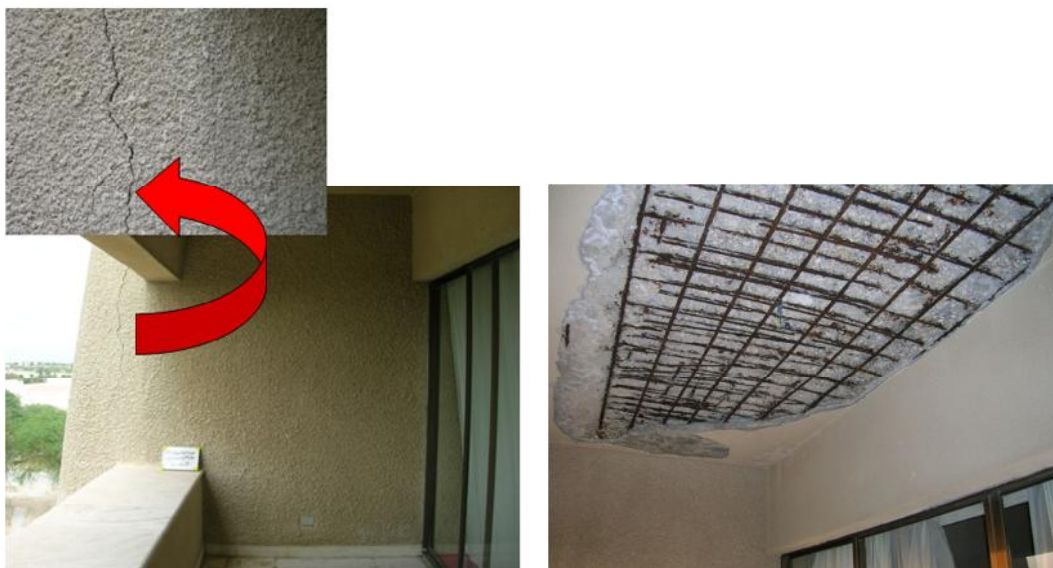
شکل ۵- ارزیابی چشمی سقف و ترک‌های موجود در تراس
