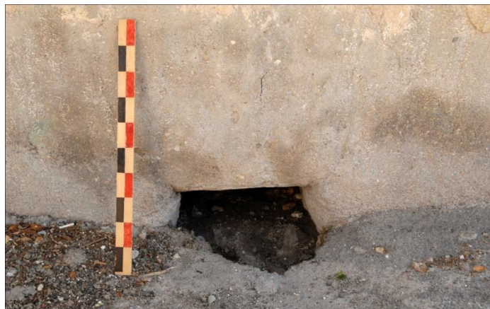
شکل ۱۵: نمایی از مسدود شدن دریچه ورود آب به آب‌انبار
