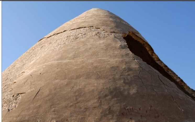
شکل ۱۰: نمایی از سقف فرو ریخته یک آب‌انبار با قطر مخزن بزرگ
