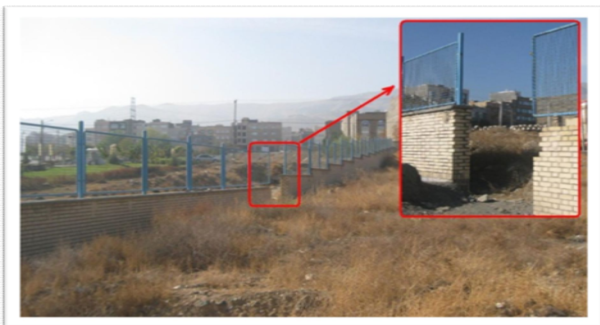
شكل ۲) حفاظت فيزيكى ضلع شرقى؛ راه نفوذ
