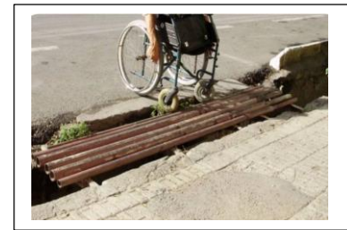
تصویر شماره ۱۹، پل عبوری نامناسب
