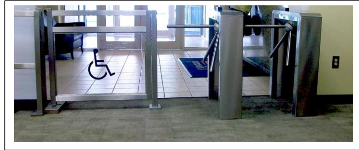
تصویر شماره ۱۱، درب‌های ورودی جهت عبور ویلچر
