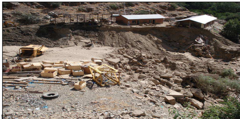
تخریب تجهیزات کارگاه پل شماره ۶ پیمانکار چینی آزاد راه تهران-شمال
