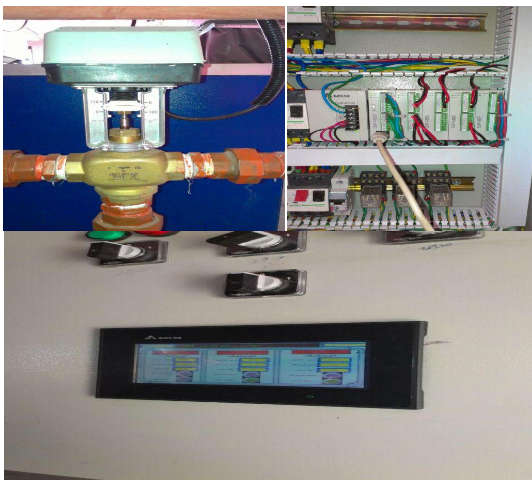
شکل ۳- سیستم های PLC و مانیتورینگ پس از نصب
