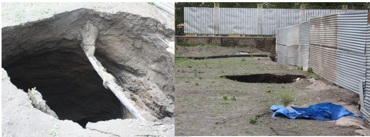
شکل ۱: نمایی از ریزش صورت گرفته در محدوده ورودی TBM شرقی
